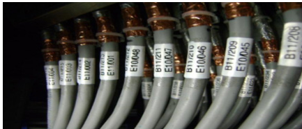
Figura 5: Cabos de link permanente identificados no patch panel
