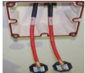
Figura 6: Cabos de link permanente identificados na área de trabalho
