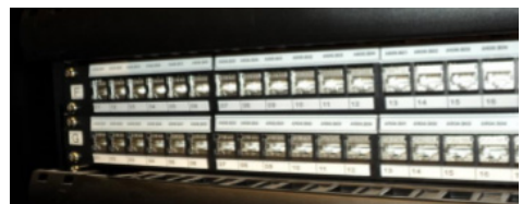
Figura 8: Identificação das portas do patch panel
