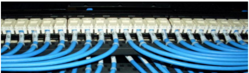
Figura 12: Exemplo de cabos fixados no guia traseiro do patch panel
