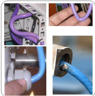
Figura 12: Exemplos de cabos NÃO respeitando o seu raio de curvatura
