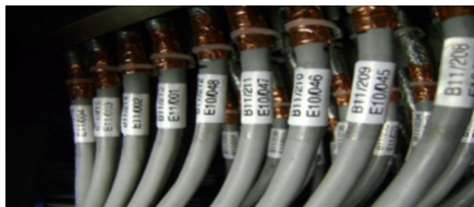
Figura 8: Cabos de link permanente identificados no patch panel
