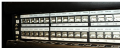
Figura 11: Identificação das portas do patch panel
